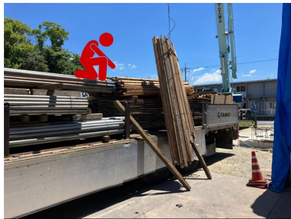
(玉外しした荷に押され一緒に被災者も墜落した)
